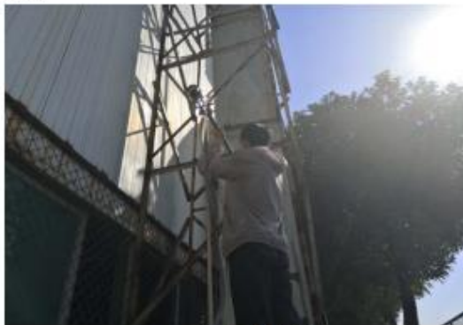
02 成型焊接排气筒出口
