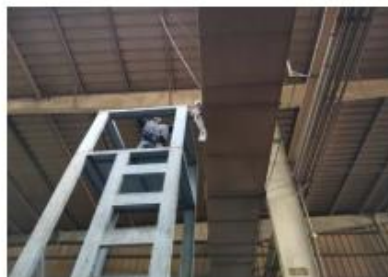
02 吸塑车间废气排气筒出口
